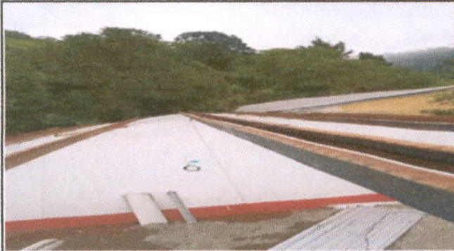
Foto 1: MÓDULO 1 AULAS CUBIERTA DE LÁMINA: Sustitución de lámina, por lámina troquelada aluzinc calibre 26, Sustitución de capote de lámina para lámina troquelada
