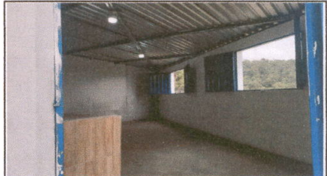
Foto 4: MÓDULO 3 COCINA CUBIERTA DE LÁMINA: Sustitución de lámina, por lámina troquelada aluzinc calibre 26, ESTRUCTURA DE TECHO: Mantenimiento a estructura de soporte de metal
